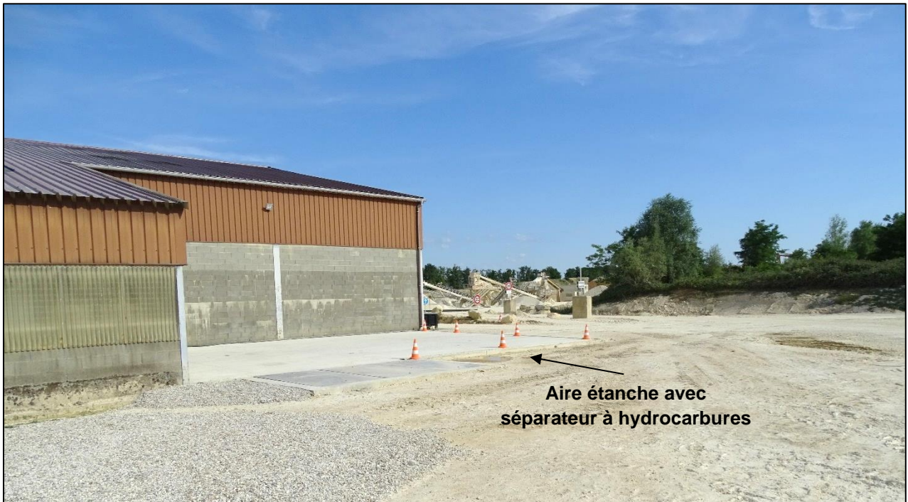
Figure 17 : Aire étanche bétonnée munie d'un séparateur à hydrocarbures dans l'angle sud-ouest du hangar de stockage (juin 2020)
