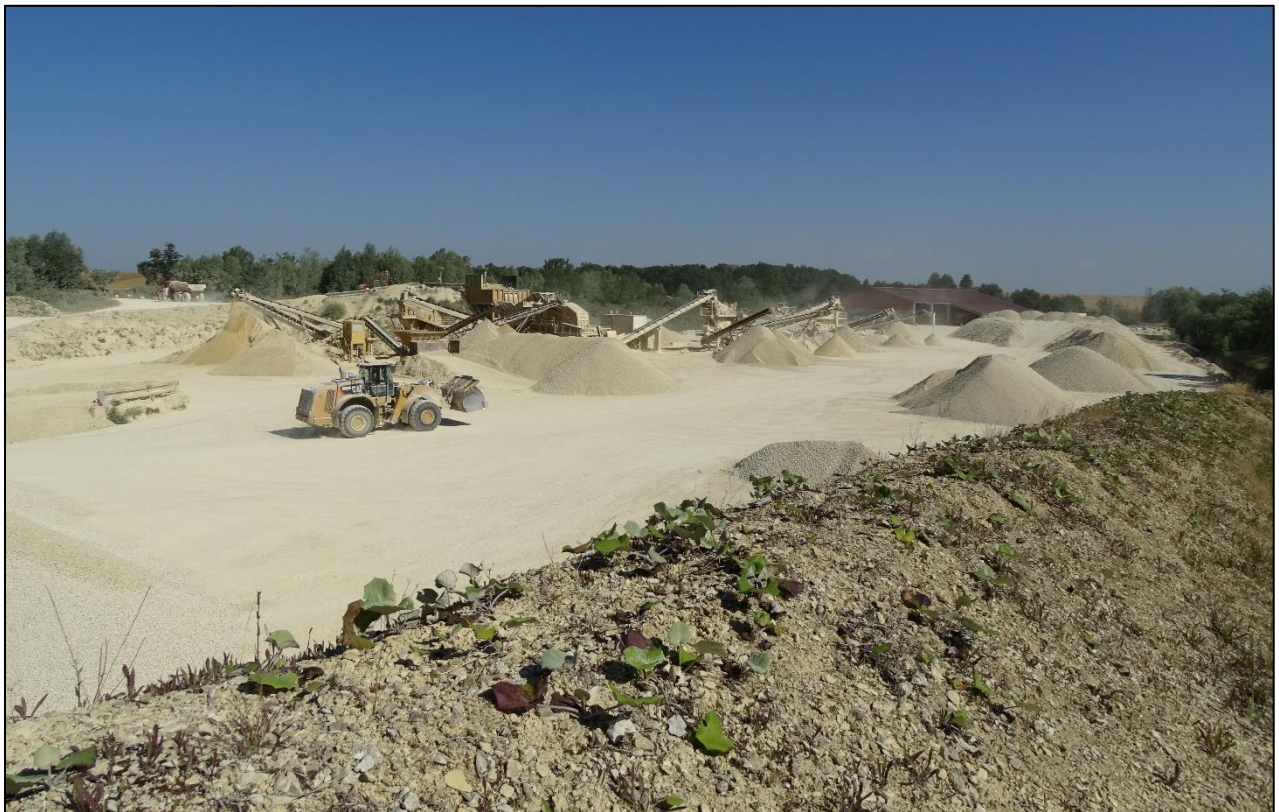
Figure 12 : Installation de traitement fixe principale sur la plateforme technique ; vue depuis le secteur sud-est (juin 2020)
